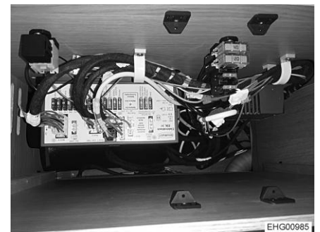
Fig. 83 Emplacement bloc électrique (Ford)
